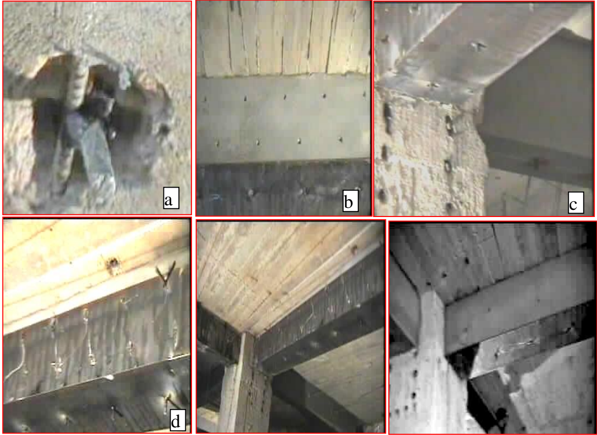
Şekil 4.10. Kirişlerin çelik levhalar ile onarım-güçlendirilmesi örnekleri
