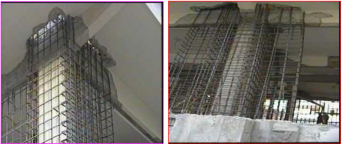
Şekil 4.13. Kolon kiriş birleşim bölgesi onarım-güçlendirme uygulaması
