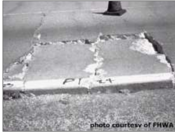
Şekil 4.3. Kaplama kenarında oluşmuş zımbalama.
