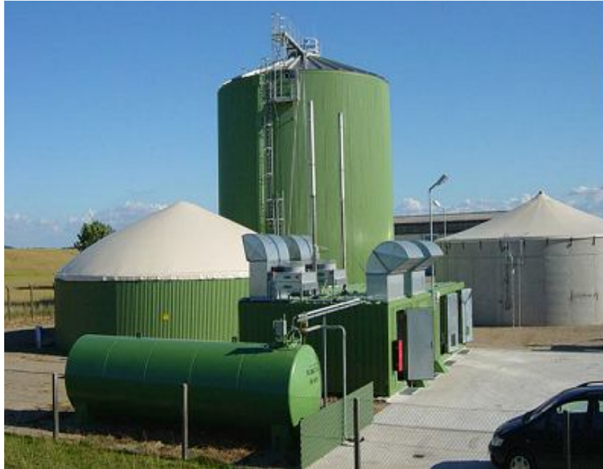
Şekil 3.19. Almanya'da Bir Biyogaz Tesisi ( www.biyogaz.web.tr )
