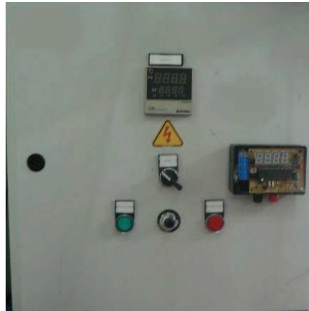
Şekil 6.23 Elektrik panosunun ön kapak fotoğrafı
