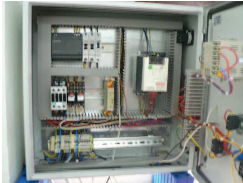
Şekil 6.17 Elektrik panosunun iç fotoğrafı
