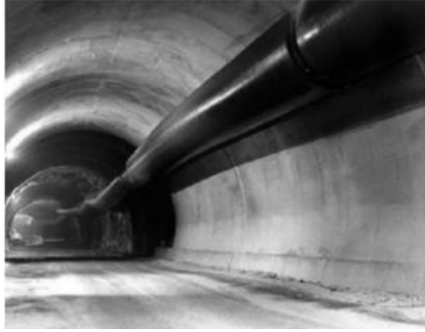
Şekil 5.1 Tünel inşası sırasında kullanılan bir havalandırma kanalı [27]
