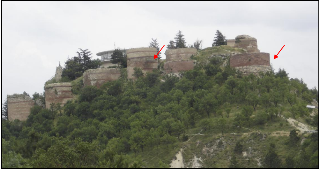
Şekil 4.1. Kütahya kalesinin burçlarında gözlenen onarım izleri
