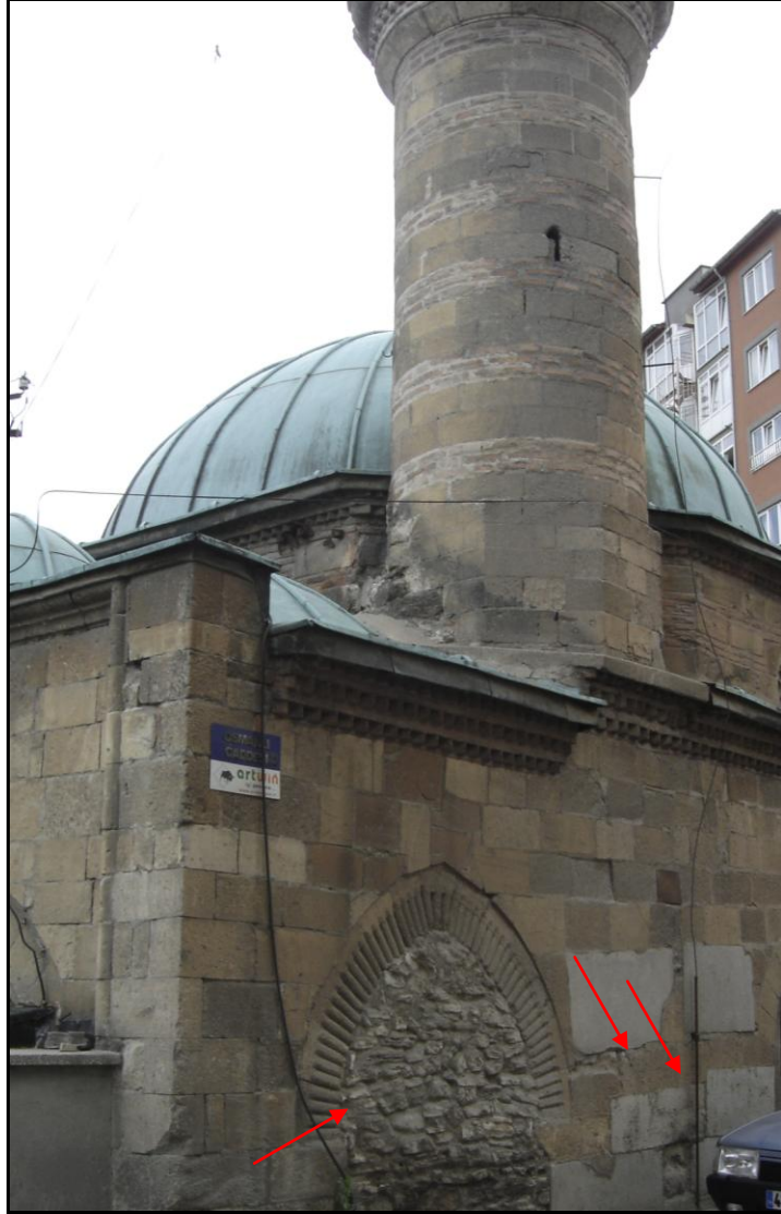
Şekil 4.3. Meydan Camii'nde gözlenen onarım izleri.
