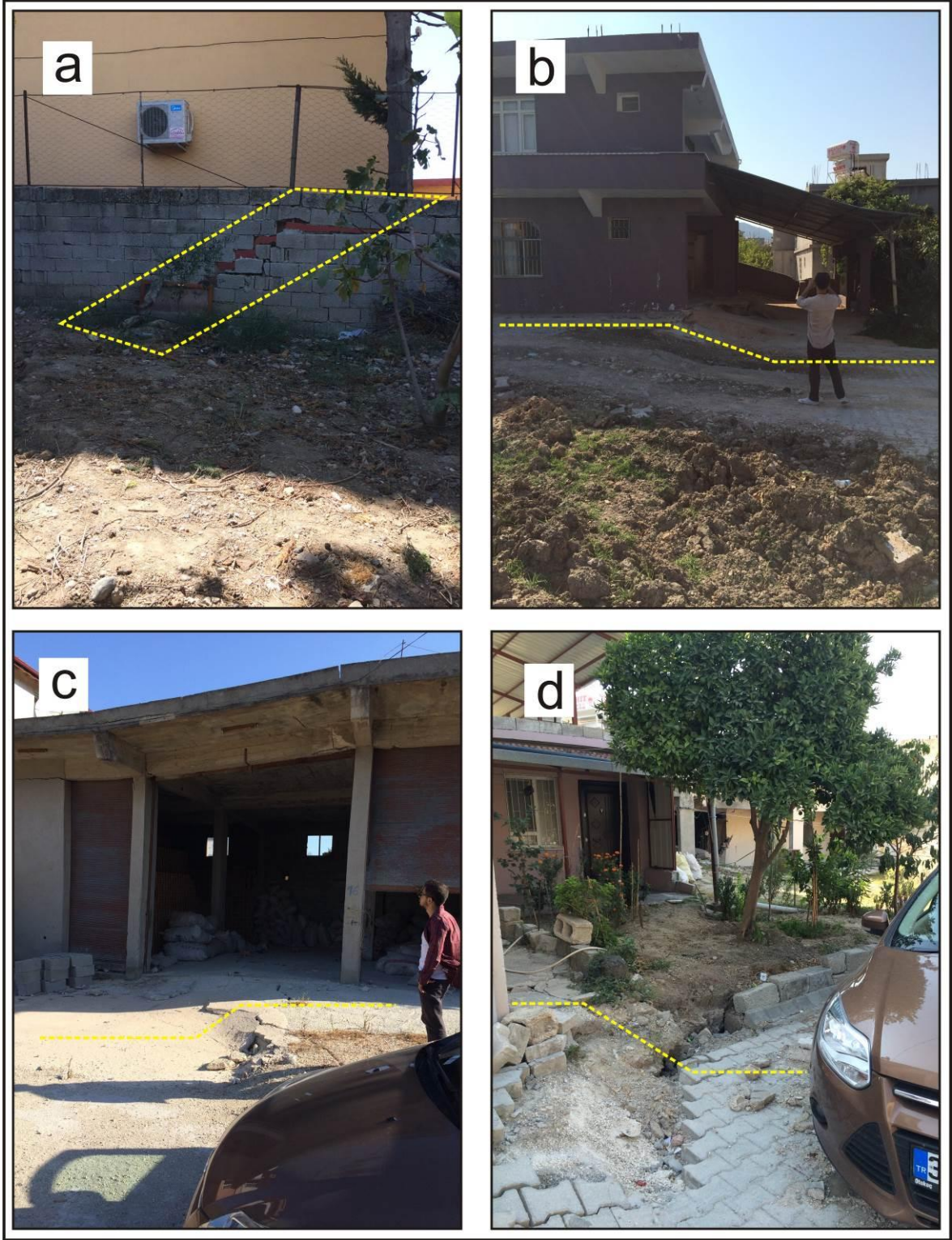
Şekil 6.3. Kırık üzerinde inşa edilmiş yapılarda görülen hasarlar.
