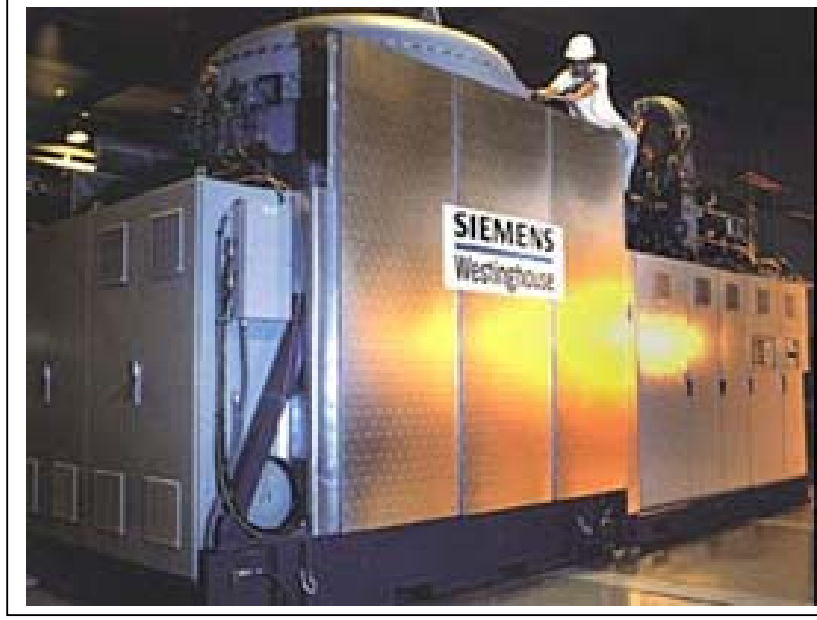
Şekil 4.10. Kaliforniya’da Kurulu 220 kW Kapasiteli Gaz Türbinli ve Katı Oksit Yakıt Pili Kojenerasyon Enerji Santrali (Fuel Cell Today, 2006)
