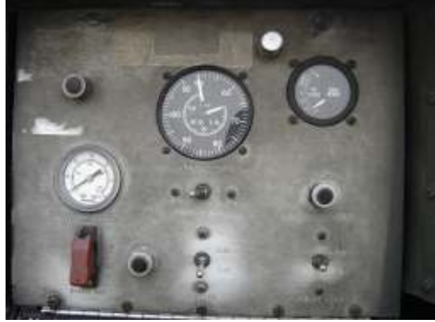
Şekil 3.2: Motor Kontrol ve Kumanda Paneli
