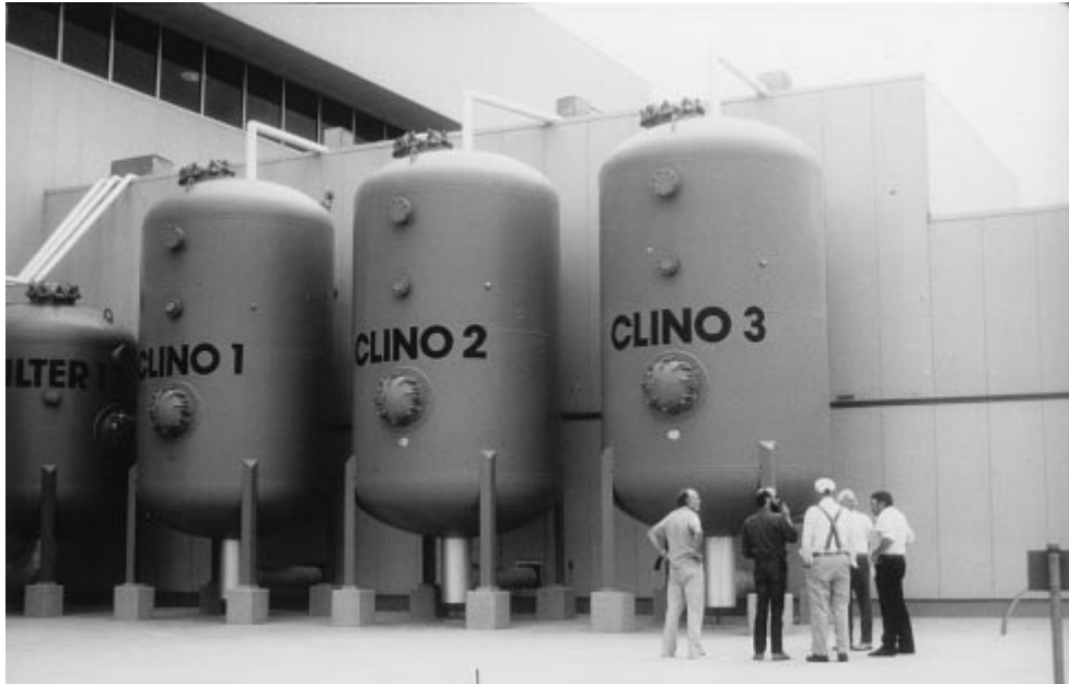
Şekil 2.8 Denver'da su arıtma tesisinin klinoptilolit doldurulan sütunları.
