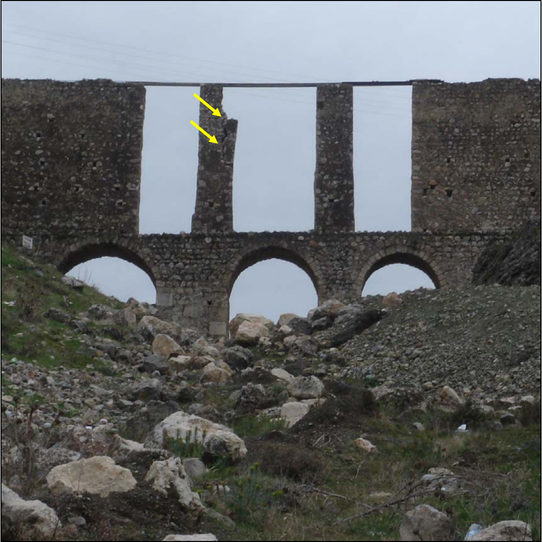
Şekil 6.26. Darbısak Kalesi'ne, hemen batısındaki dağlardan su getirmek için yapılmış bir kemerin üst kesimleri tamamen yıkılmıştır. Kemerin ayaklarında ise boydan boya kırıklar dikkati çekmektedir (sarı oklar çatlakları işaret etmektedir).
