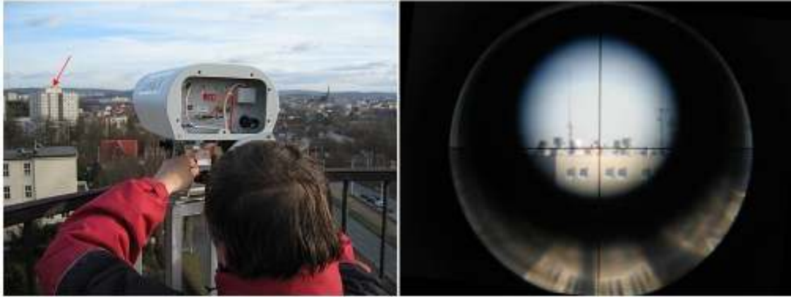
Şekil 3.3 Serbest uzay optik haberleşme sistemi kurulumu. Hattın diğer ucu soldaki resimde görülen büyük beyaz bloğun çatısında olup, sağda ise bu nokta optik pointer ile görüntülenmektedir ( http://www.cesnet.cz/doc/techzpravy/2007/mrv-terlescope-700/ ).
