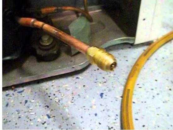
Şekil 2.3. Sistem gaz kaçağına neden olan soğutucu boru
