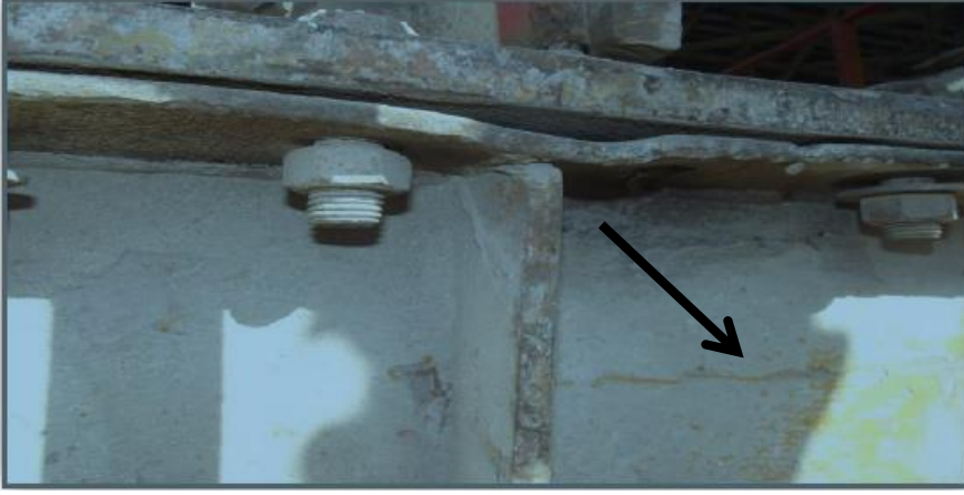
Şekil 3.1.Gözle Muayene Sonucunda Tespit Edilen Plastik Deformasyon ve Çatlak Örneği
