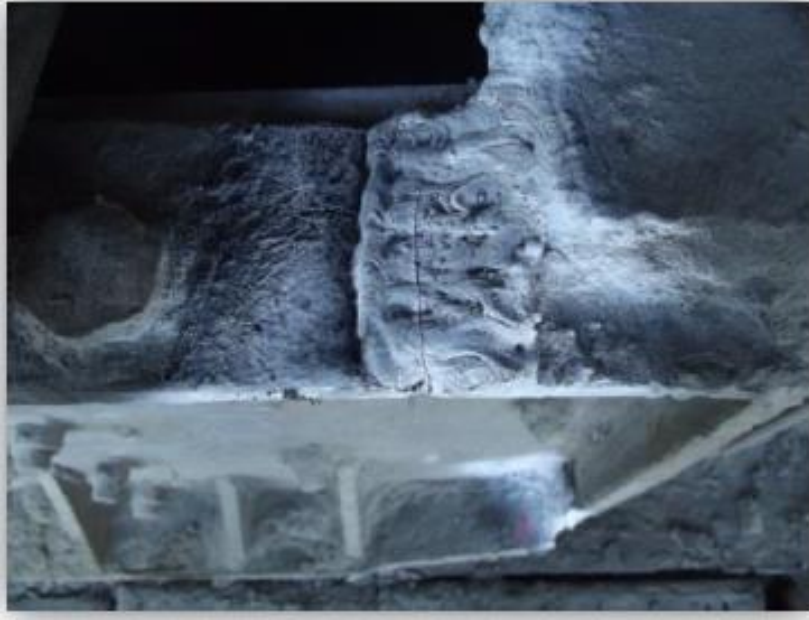
Şekil 3.6.Manyetik Parçacık Testi Sonucunda Elde Edilen Bulgu-Çatlak Örneği
