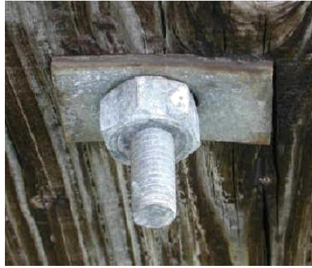
Şekil 2.4. Farklı metallerin oluşturduğu korozyon (galvanik korozyon)
