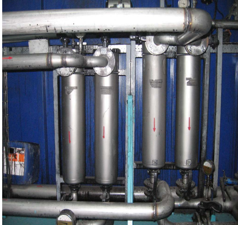
Şekil 5.2. Yeni yapılan filtreleme sistemi
