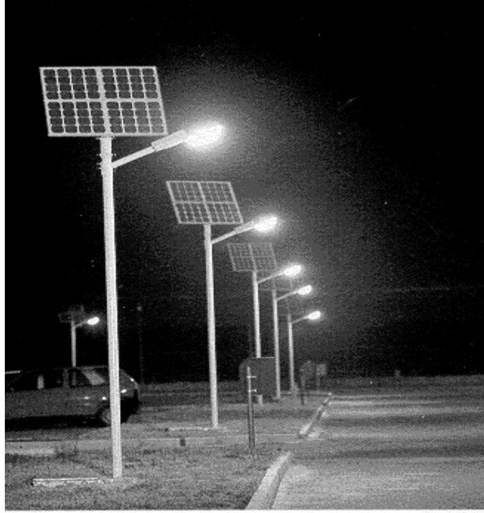
Şekil.7.7. Güneş pillerinin sokak aydınlatmasında kullanımının fotoğrafı
