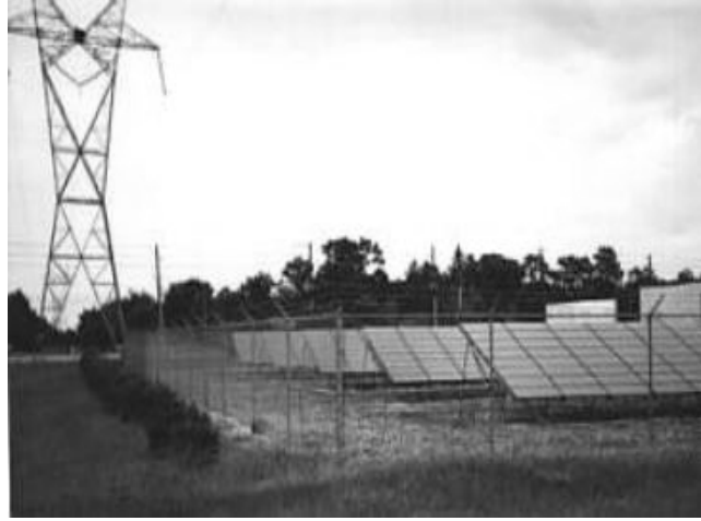
Şekil 7.12. Şebekeye elektrik veren bir güneş pili santralının fotoğrafı
