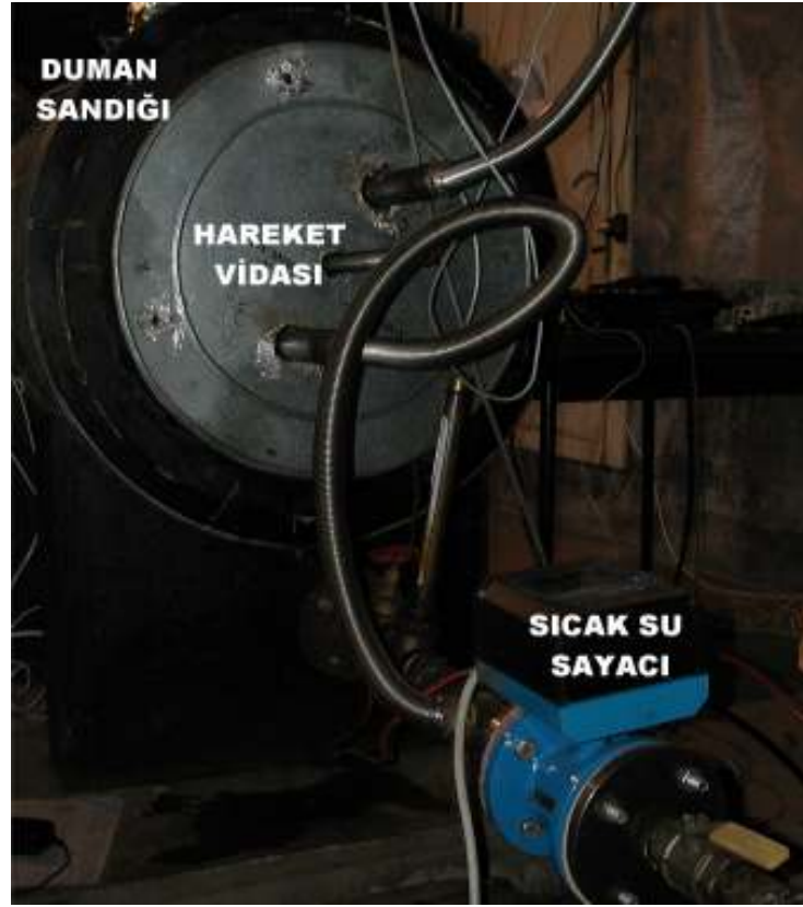
Şekil 5.7. Sıcak su sayacının montaj halindeki görünüşü.
