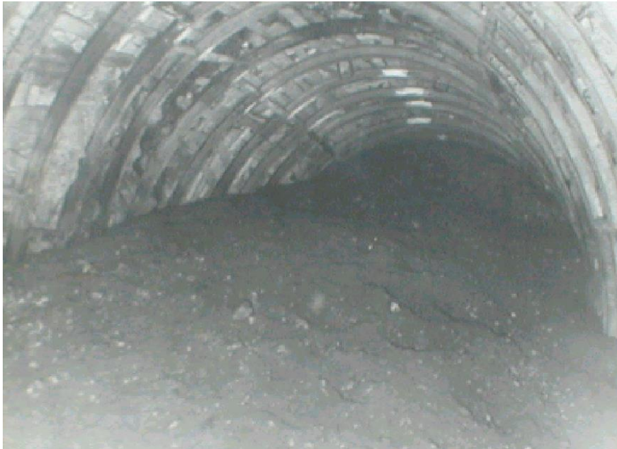
Şekil 9.1. Kozlu -425/22929 Çay rekup lağımında degaj sonrası arının görünüşü
