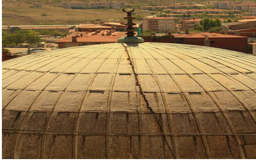
Şekil 9.16: Kubbede hasar oluşumu
