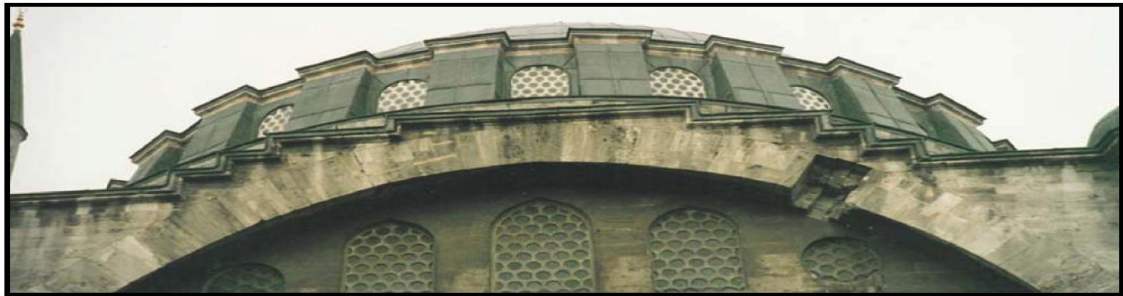
Şekil 9.13: 17 Ağustos 1999 Kocaeli depreminden sonra Edirnekapı Mihrimah Sultan Camii kemerinde oluşan hasar
