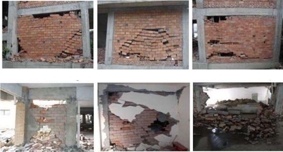
Şekil 4.5. 2008 Wenchuan depreminde, değişik türlerde hasar görmüş dolgu duvar örnekleri (Li, 2008)
