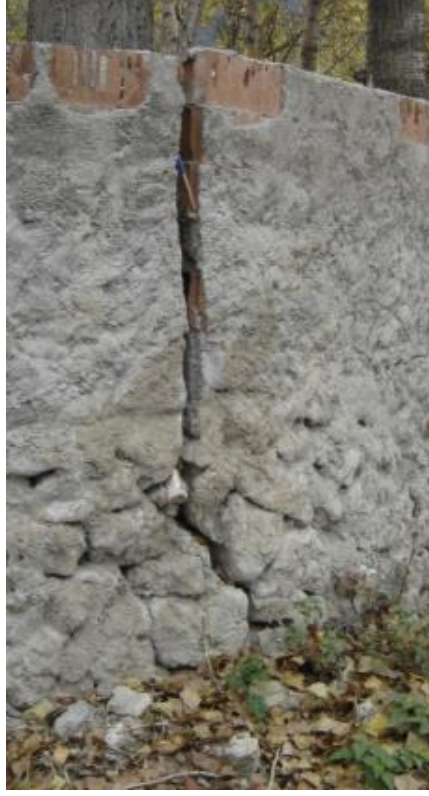
Şekil 6.26. İncegöz Köyü'nde fay zonu üzerinde bulunan bir bahçe duvarında kırılma.
