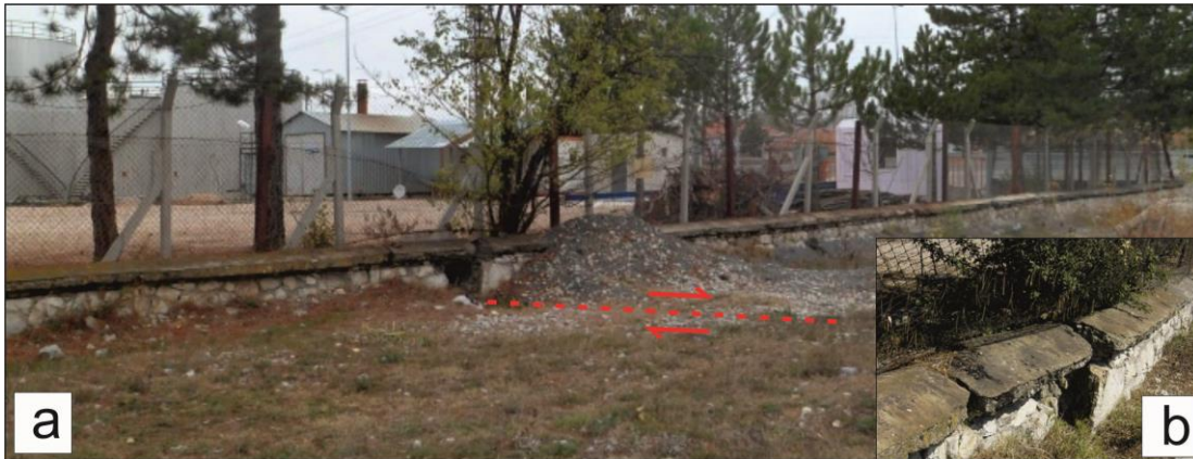
Şekil 3.6a. 1944 depremi yüzey kırığı üzerinde yer alan İsmetpaşa asfalt istasyonu duvarı (fay uzanımı kırmızı kesikli çizgi ile görülmektedir). b. Duvar üzerinde krip nedeniyle gözlemlenen ötelenmenin yakından görünümü.
