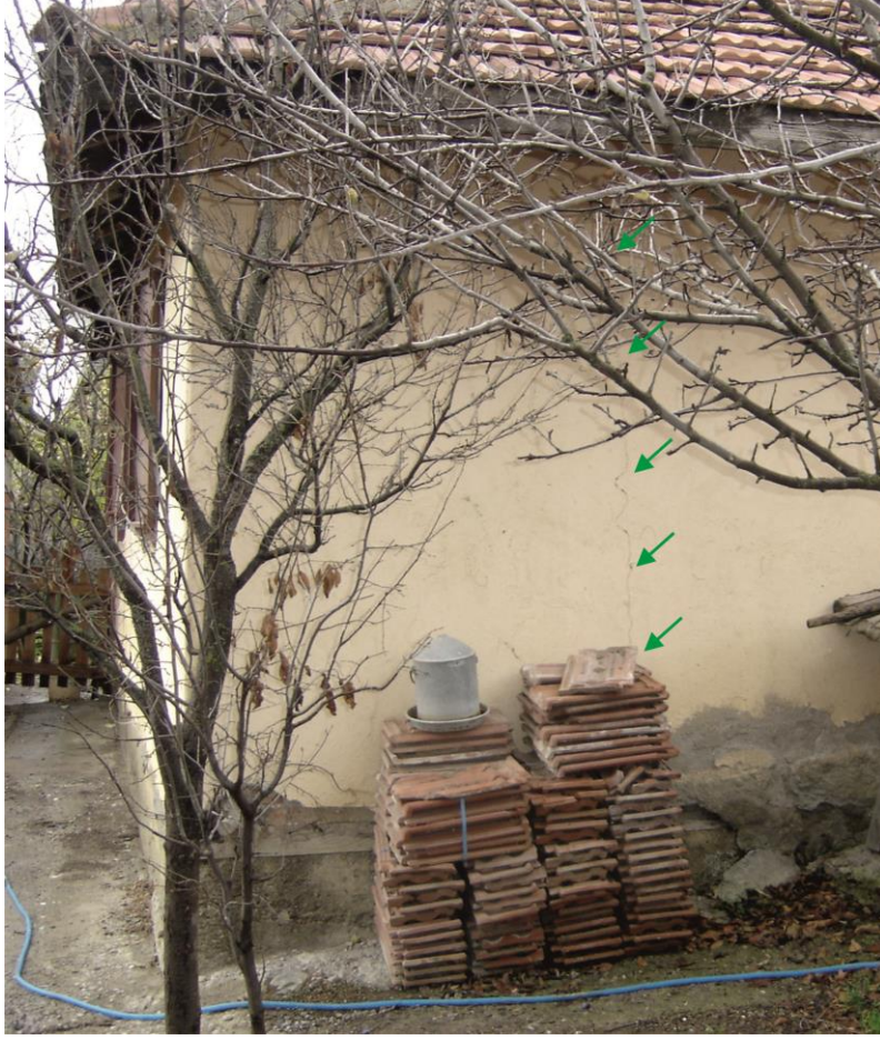
Şekil 6.14. Kapaklı Köyü'nde fay zonu üzerinde bulunan bir evin duvarında gözlenen çatlaklar.
