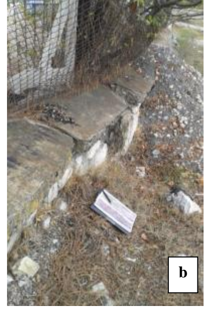
Şekil 6.16. KAFZ üzerinde krip hareketinin ilk gözlemlendiği lokasyon (İsmetpaşa'daki asfalt istasyonunun duvarı). a. Duvarın genel görünümü, b. Duvarın kırılmış kısmının yakın görünümü.
