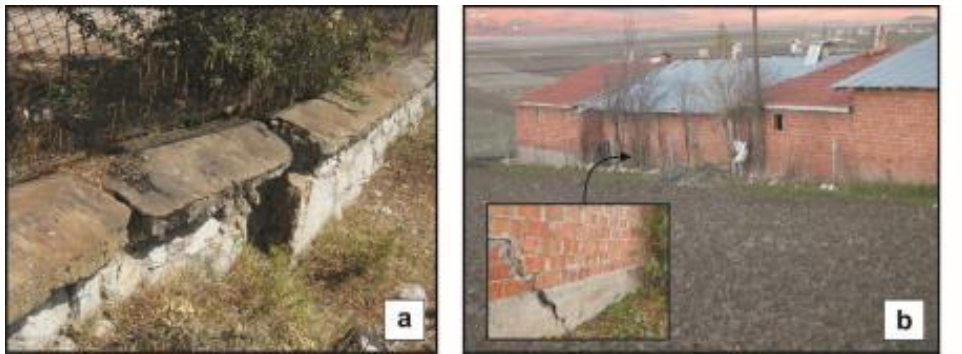
Şekil 3.5. Günümüzde krip sonucu deformasyonun görüldüğü yerler. a) 1960’lı yıllardan bu yana izlenmekte olan krip hareketinin görüldüğü İsmetpaşa’daki karayolları bakım istasyonunun duvarı, b)Hamamlı’daki ahır duvarı.
