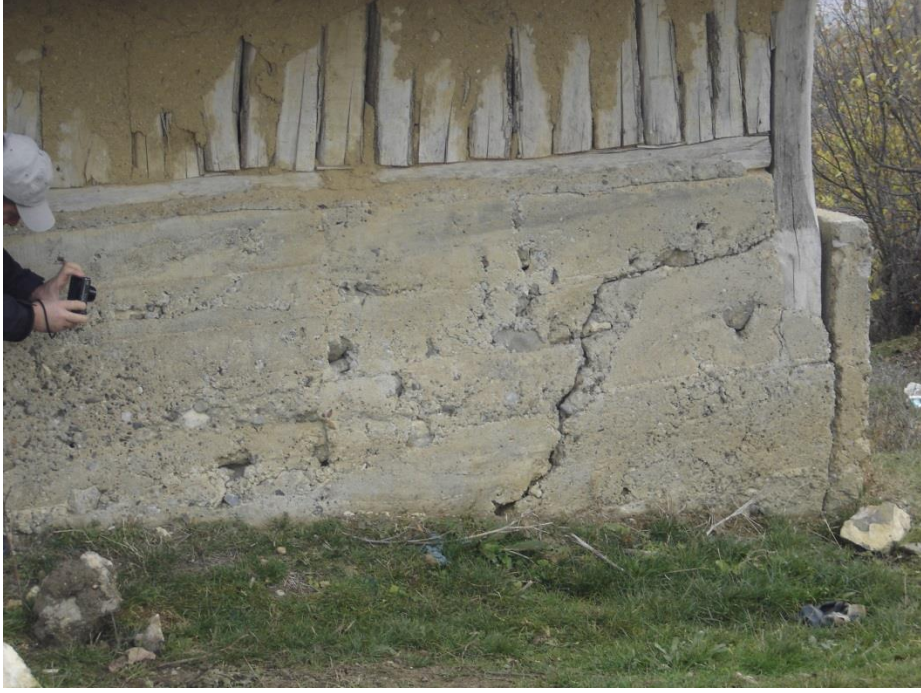
Şekil 6.28. Kiran K y 'nde fay uzanımı  zerindeki bir evin duvarındaki hasar.
