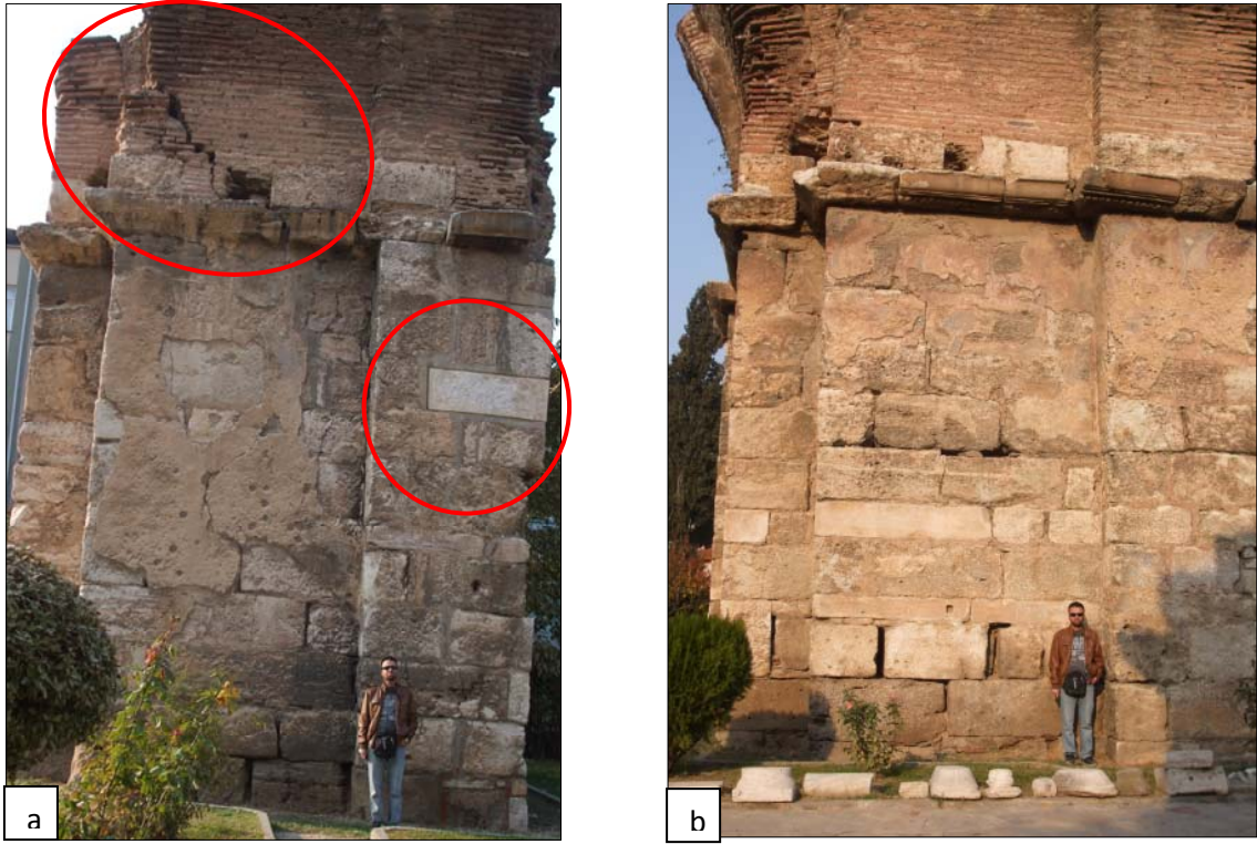
Şekil 6.12. a ve b. St. Jean Kilisesinin duvarlarında gözlenen sarsıntıya bağlı oluşan açılma çatlakları, yıkılan yerlerin farklı taşlarla restore edilmiş hali.
