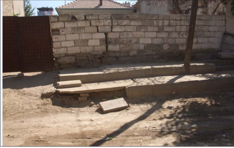
Şekil 6.30. Düşen kaldırım ve yenilenmiş hali.
