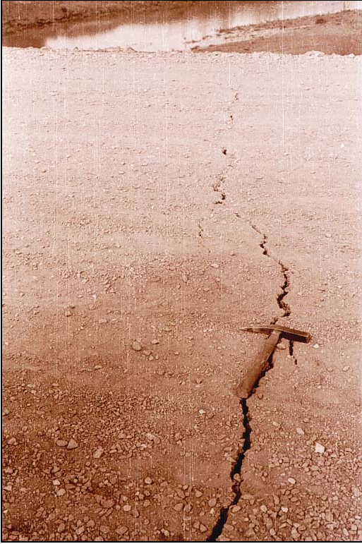
Şekil 5.4. Kemaliye-Alaşehir eski yolu üzerinde K80B uzanımlı yolu kesen yüzey deformasyonu (Karamanderesi, 2000).
