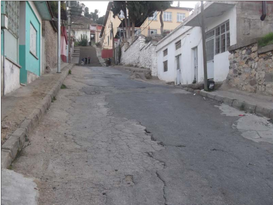
Şekil 6.45. Yollarda gözlenen deformasyonlar.
