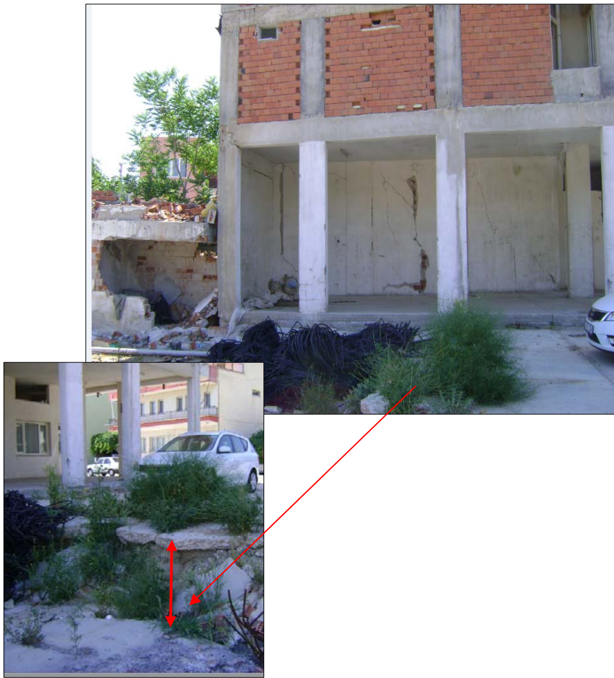
Şekil 6.20. Ayhan mahallesindeki bina tabanında görülen 80 cm'lik düşey yerdeğiştirme ve inşaat halindeki binada gözlenen çatlaklar (648469 D/4234252 K).
