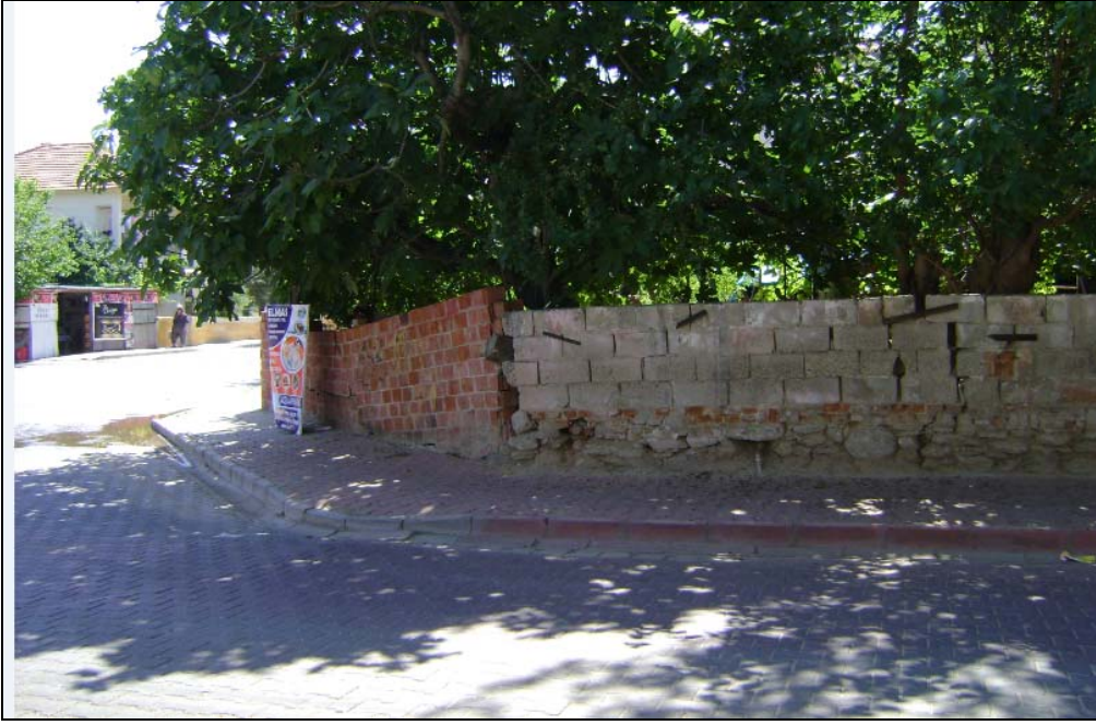
Şekil 6.23. Bahçe içerisinde 1969 kırığının olduğu ve deprem sonrası 20 cm düşey yerdeğiştirmenin olduğu bahçe (648324 D/4234287 K).
