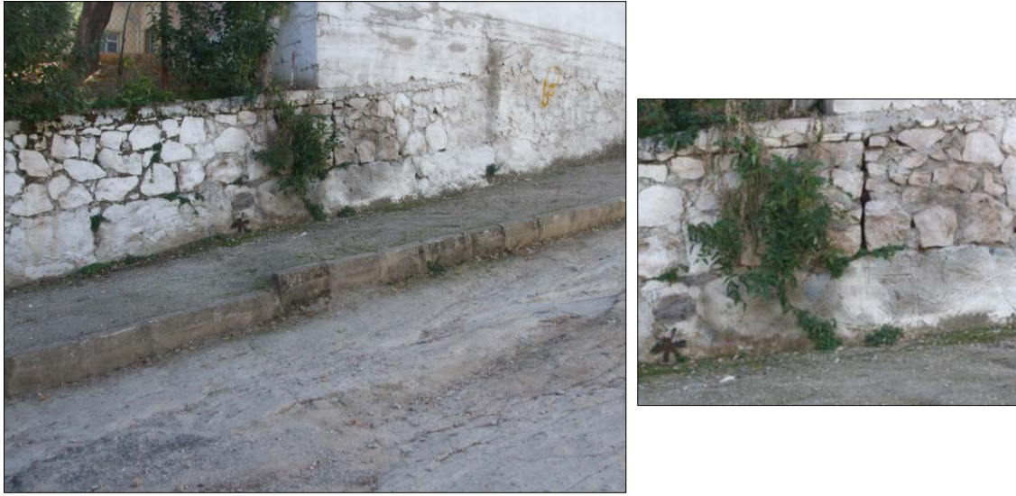
Şekil 6.48. İlçe merkezinde yollarda ve duvarlarda gözlenen deformasyonlar.
