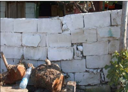
Şekil 6.39. Kırık üzerindeki duvarlarda oluşan deformasyonlar ve tadilatlar.
