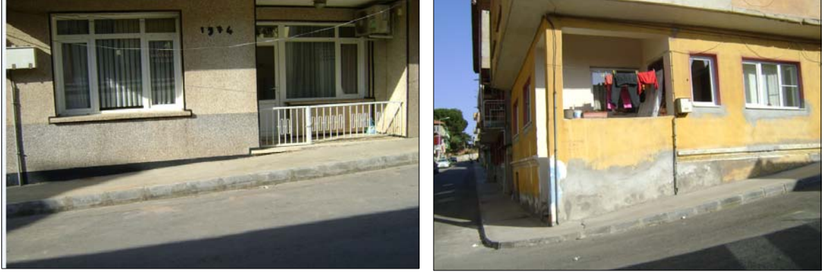
Şekil 6.44. Evlerin tabanlarında gözlenen deformasyonlar.
