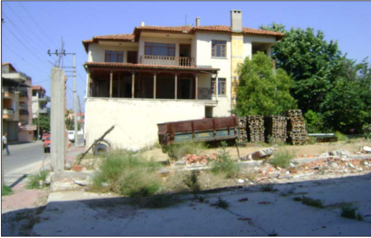
Şekil 6.21. Deformasyondan dolayı boşaltılan bir bina.
