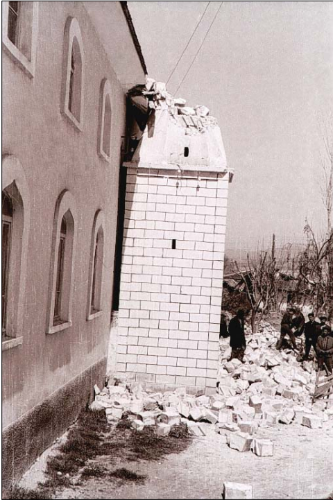
Şekil 5.11. Alaşehir-Piyadeler’de cami minaresi batıya doğru yıkılmış. Fotoğraf kuzeyden güneye çekilmiştir (Karamanderesi, 2000).
