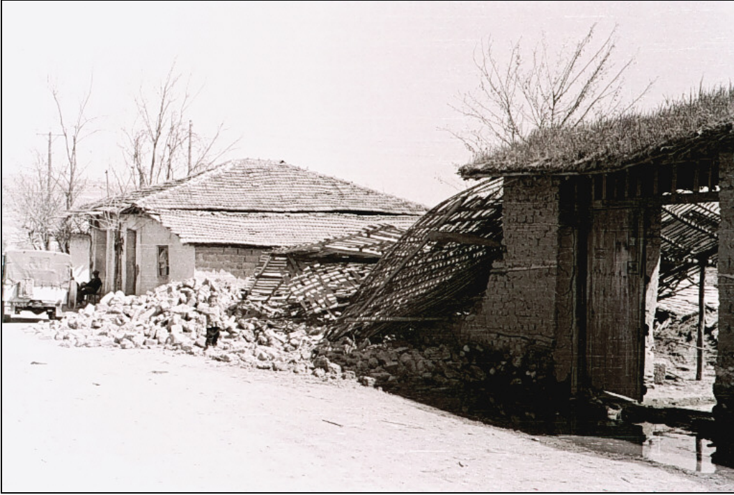
Şekil 5.12. Piyadeler Köyü'nde evlerin kuzey ve batı duvarları yıkılmış (Karamanderesi, 2000).
