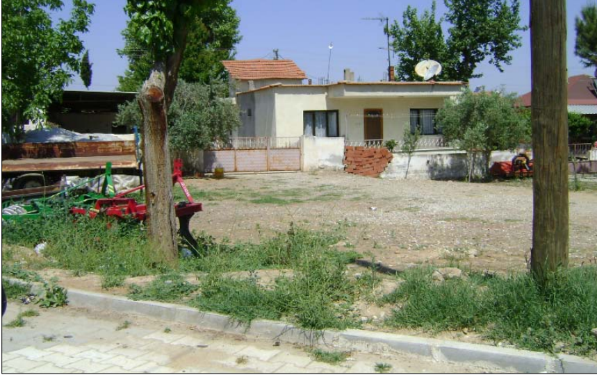
Şekil 6.18. Deformasyondan dolayı ortası yeniden örülen duvar.
