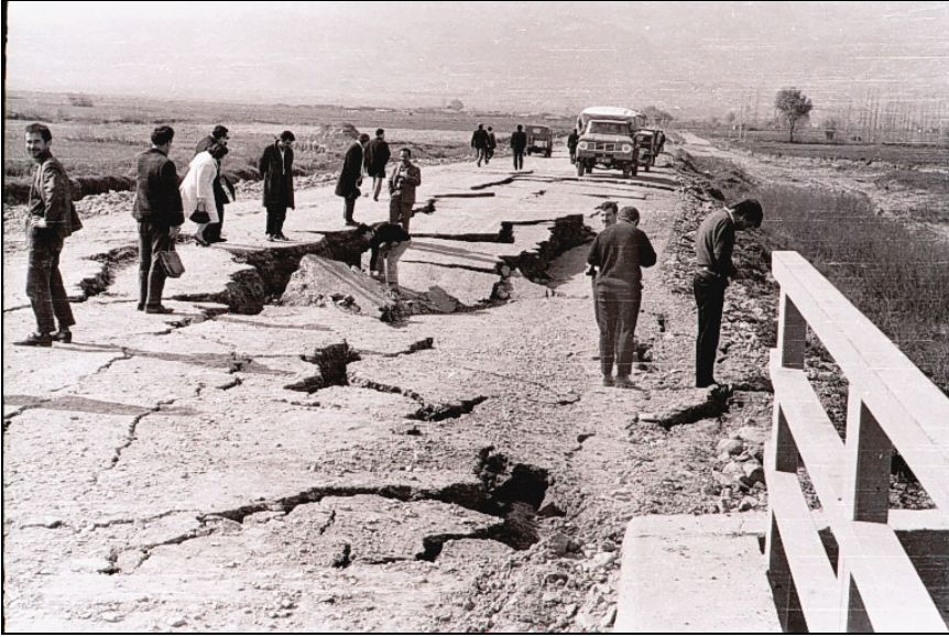
Şekil 5.6. Alaşehir-Kemaliye yolu Baklacı köprüsü güney sahili. Köprü ayağı yanında yüzey deformasyonunu ölçen Ergun Havur K80B uzanımlı Baklacı Piyadeler fay hattı görülüyor (Karamanderesi, 2000).
