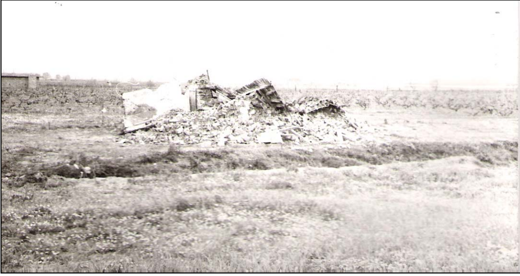
Şekil 5.17. Kemaliye-Toygar-Piyadeler yolu üzerinde Toygar bağları mevkiinde basit evlerin yıkılması (Karamanderesi, 2000).
