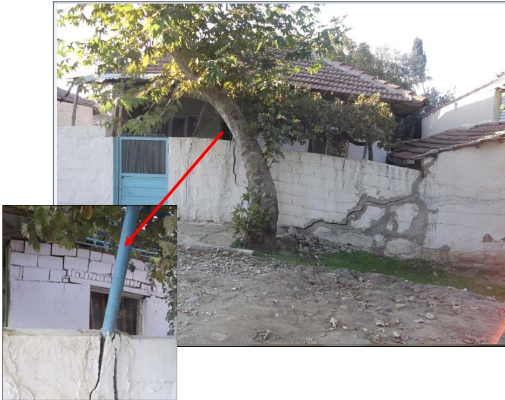
Şekil 6.19. Duvar ve üzerindeki demir direktteki deformasyon (648102 D/4234400 K).
