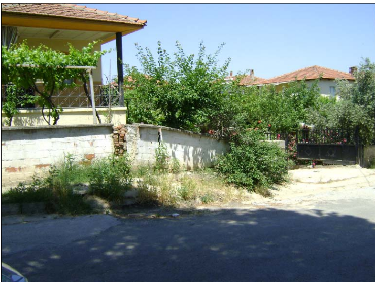
Şekil 6.16. Bahçe duvarı üzerinde gözlenen düşey yerdeğiştirme.
