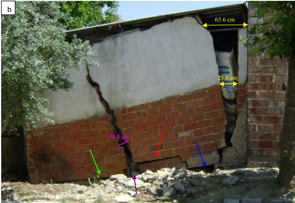
Şekil 7.2 a-b. Sarıgöl İlçesindeki bir yapıda gözlenen deformasyonlar (Şekil 7.2 a Kasım 2011’de, Şekil 7.2 b. ise Mayıs 2015 tarihinde çekilmiştir) (648109D/4234397K).
