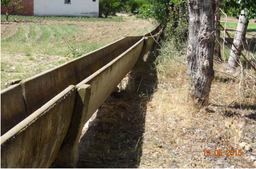
Şekil 6.34. Bereketli İlköğretim Okulu bahçesindeki DSİ sulama kanaleti üzerindeki deformasyon.
