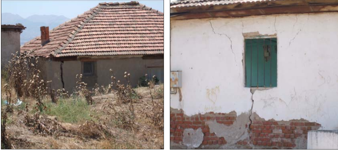
Şekil 6.51. Depremden etkilenen Killik Köyü ve hasarlı binalar (641788D/4249401K).
