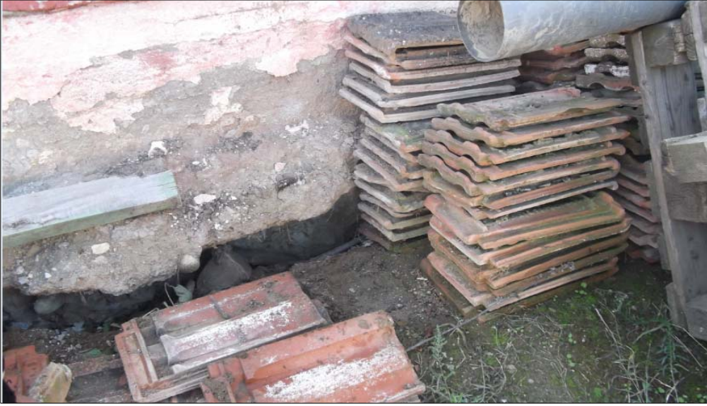
Şekil 6.38. Depremden sonra inşa edilen evlerin temellerinde oluşan açılmalar.
