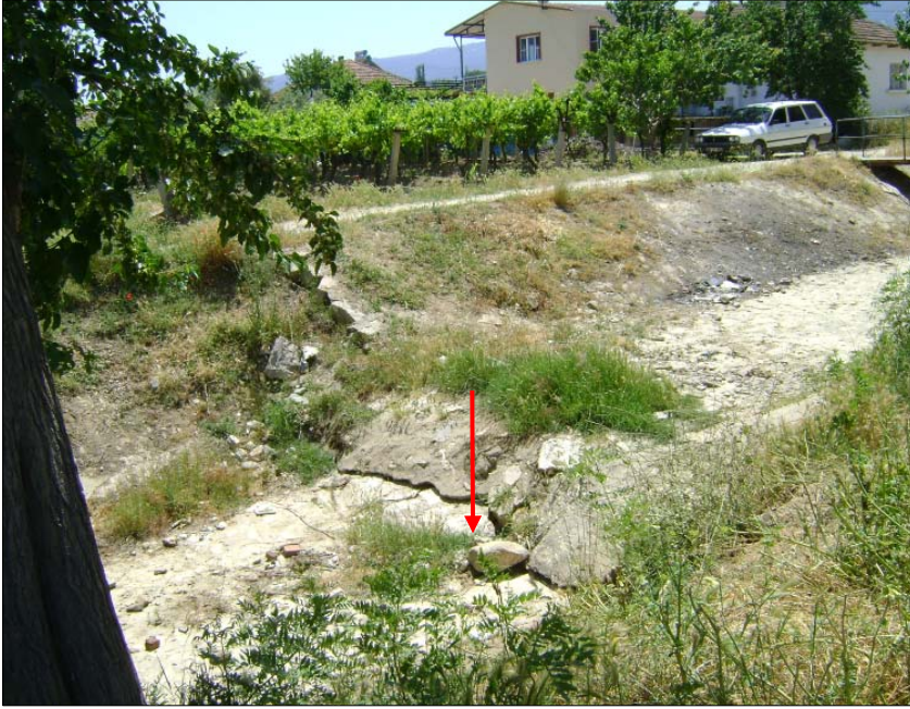
Şekil 6.15. DSİ örme taş sulama kanalı üzerindeki deformasyon (649164 D/4233736 K).
