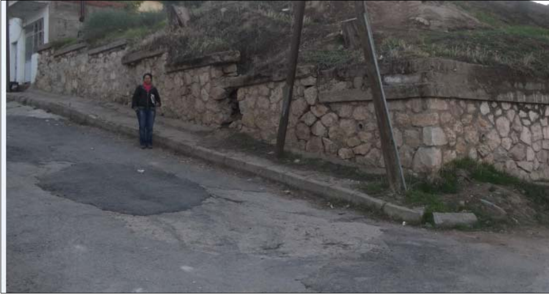
Şekil 6.46. Bahçe duvarı üzerindeki bazı deformasyonlar (632507D/4245623K).
