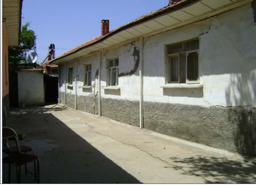
Şekil 6.26. Bina ve tabanındaki deformasyonlar (648099D/4234420K).
