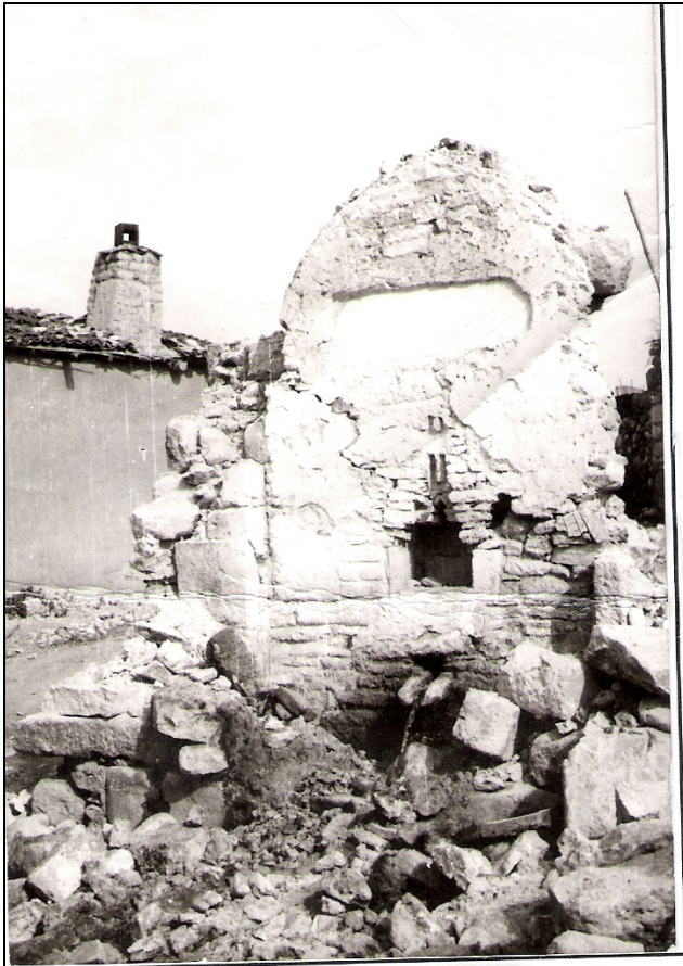
Şekil 5.18. Kemaliye’de D-B yönlü inşa edilmiş eski çeşmenin K-G uzanımlı kenar duvarlarının yıkılması (Karamanderesi, 2000).
