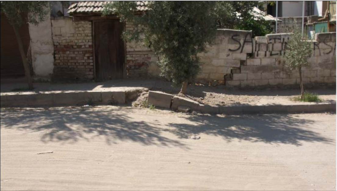
Şekil 6.27. Yolda ve duvarda gözlenen deformasyonlar.
